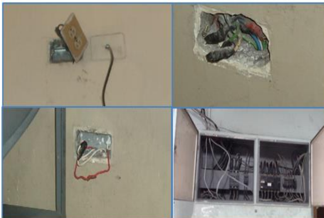
GRÁFICO No. 7 FOTOGRAFÍAS QUE DEMUESTRA RIESGO ELÉCTRICO
